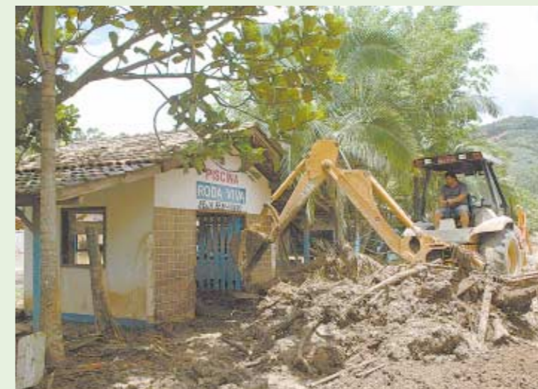
Imagem da destruição no Vale do Itajaí em novembro de 2008
