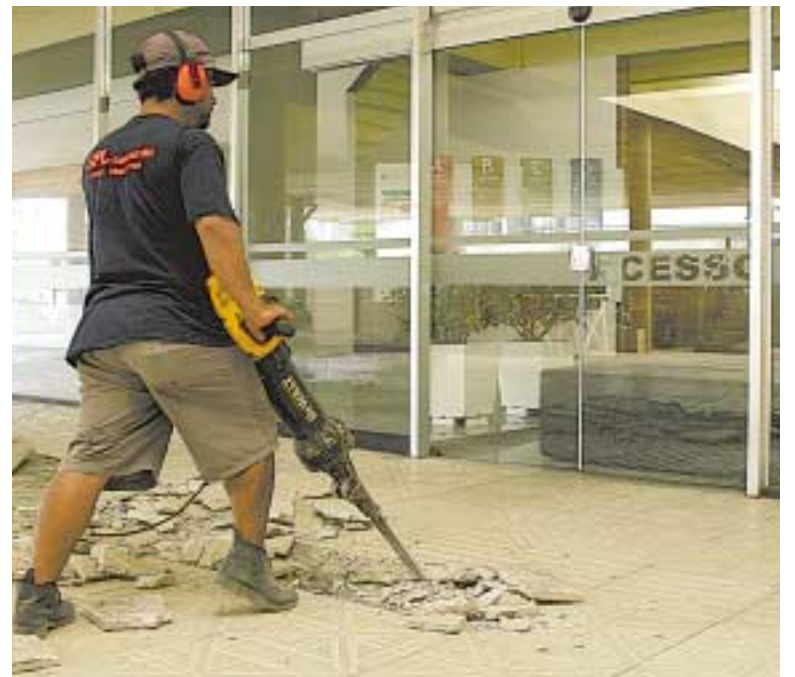
Obras devem ser concluídas em 90 dias e vão facilitar acesso ao prédio
