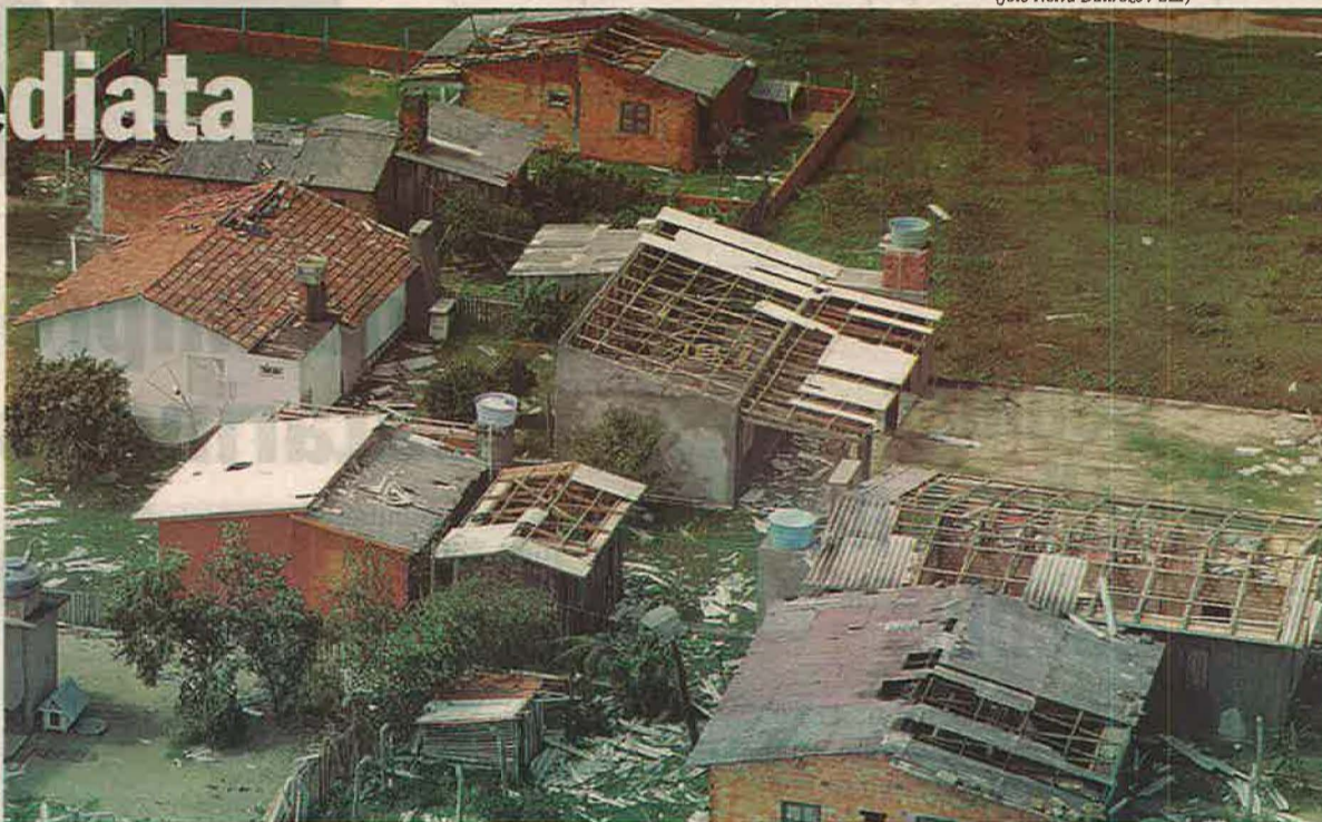
Mais de 20 mil residências foram danificadas
